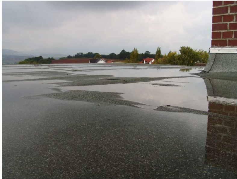
Foto 1: kein Gefälle heißt: u.U. viel stehendes Wasser, wenn die Durchbiegung der Decken zu Pfützenbildung führt und/oder – wie hier – durch ungenügende Verklebung des Dachschichtenaufbaus (und Verschiebung der Dämmplatten unter der Abdichtung) die Ebenheit der Oberfläche nicht mehr vorliegt.
