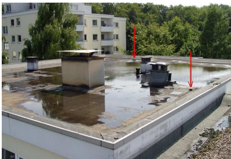
Foto 2: Auch das ist kein gefälleloses Dach: Das Kriechen der Betondecken führt zu Durchbiegungen, die Flachdachabläufe liegen – wegen der Fallrohre! - an den
