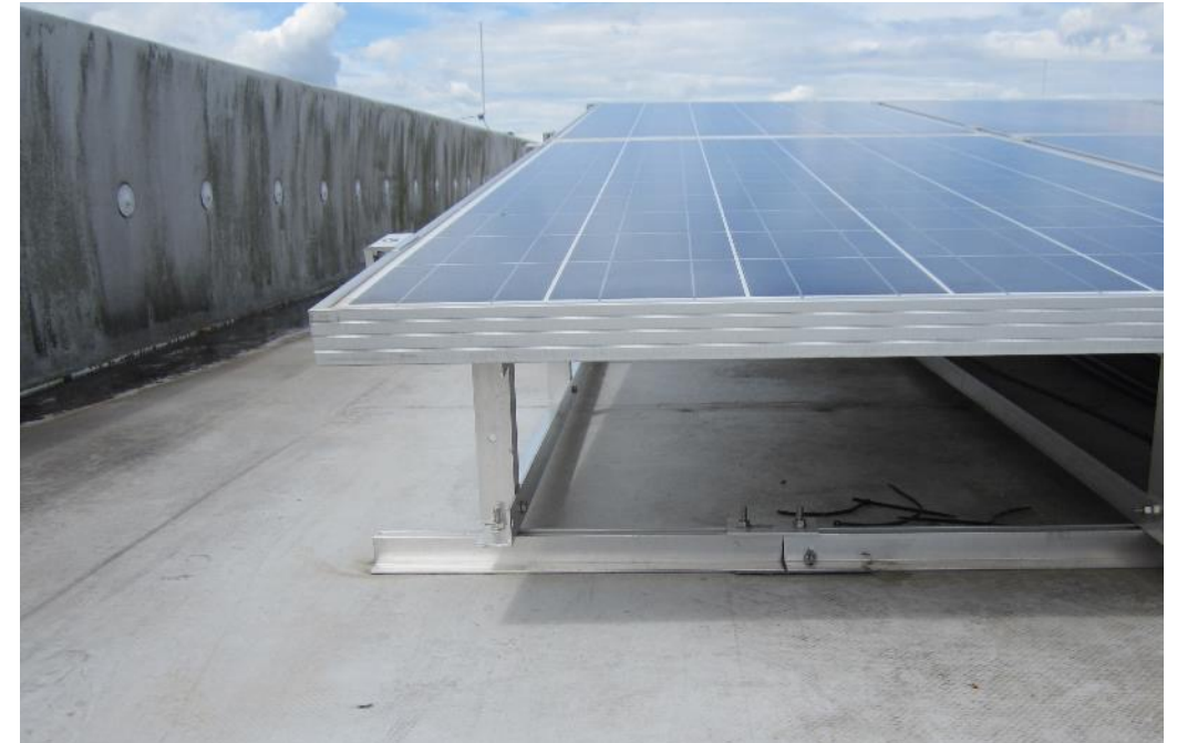
Unzureichender Bautenschutz, fehlender Bautenschutz
