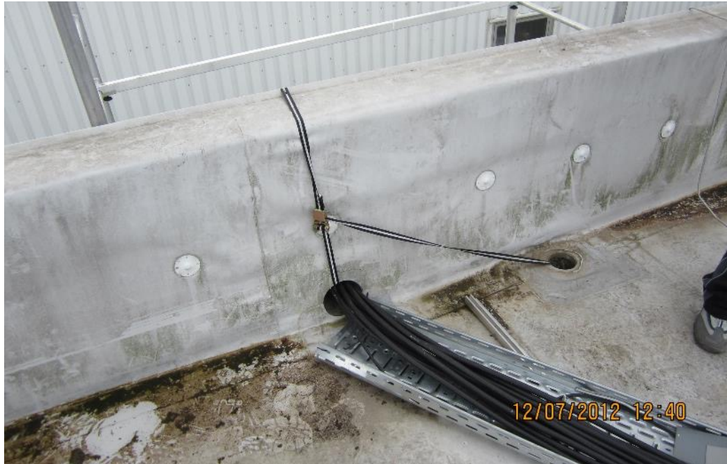
Nicht fachgerechte Leitungsverlegung, Blockade der Notentwässerung
