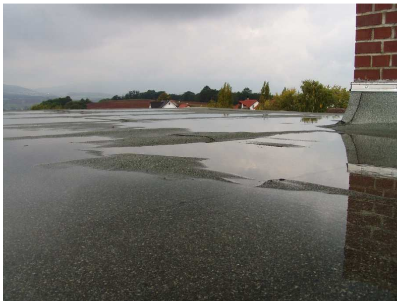
Foto 1: kein Gefälle heißt: u.U. viel stehendes Wasser, wenn die Durchbiegung der Decken zu Pfützenbildung führt und/oder – wie hier – durch ungenügende Verklebung des Dachschichtenaufbaus (und Verschiebung der Dämmplatten unter der Abdichtung) die Ebenheit der Oberfläche nicht mehr vorliegt.
