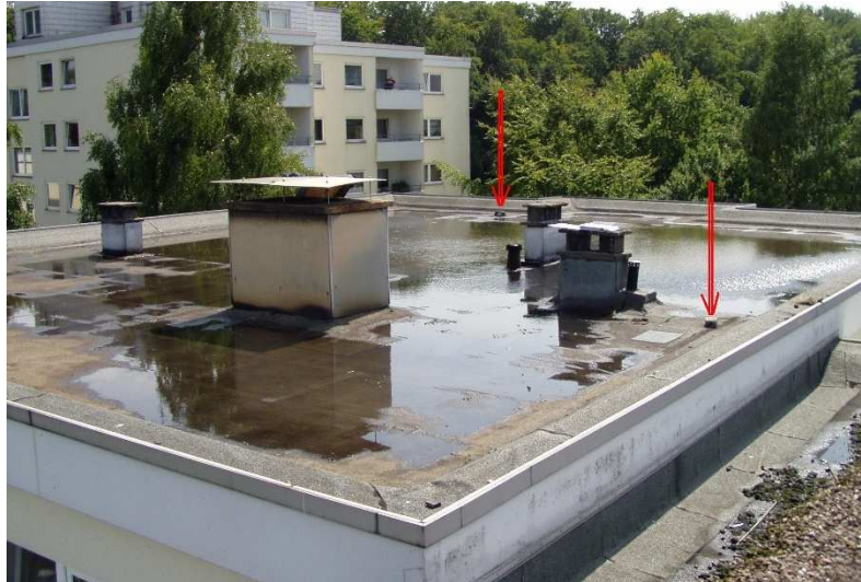
Foto 2: Auch das ist kein gefälleloses Dach: Das Kriechen der Betondecken führt zu Durchbiegungen, die Flachdachabläufe liegen – wegen der Fallrohre! - an den Dachrändern und sind ohne „shapen“ des Dämmstoffs eingebaut, eine Sanierung dieser Fläche ohne Pfützenausgleich ist mangelhaft!
