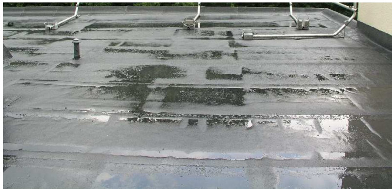
Foto 3: Selbst wenn eine gefällelose Abdichtung geplant und ausgeführt wird... ...oder im Rahmen einer Sanierung eine gefällelose Fläche hergestellt wird (mit z.B. nur einem geringen Gefälleausgleich wegen knapper Höhen) die die vorhandenen Abweichungen von der Ebenheit beseitigt und nach frischem Niederschlag geringe Pfützen aufweist, ist das um Welten besser als eine Dachfläche, auf der dauerhaft Pfützen stehen - und deshalb kein Mangel.
